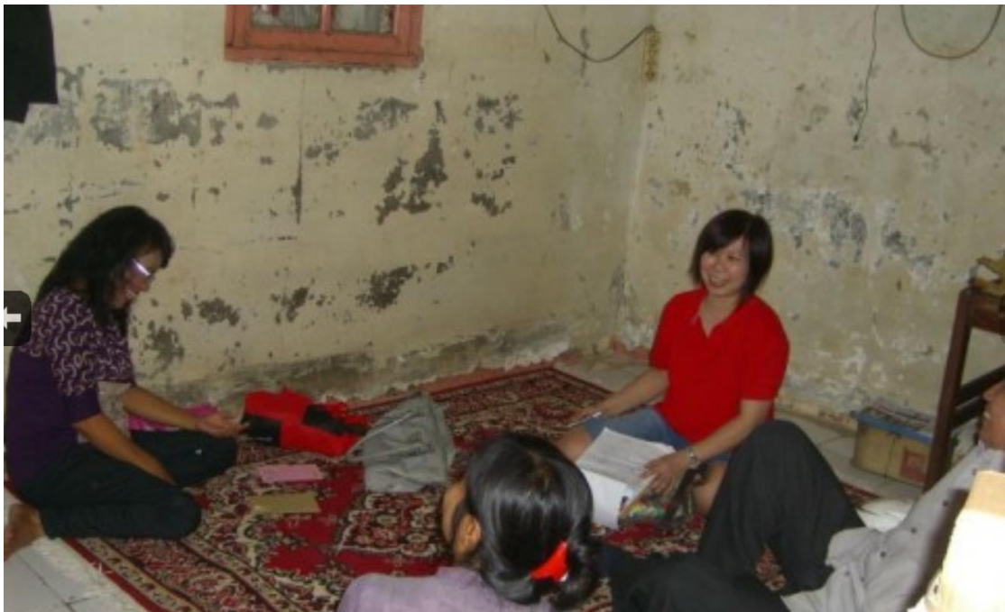
Gambar 1.3. Foto kondisi rumah penerima bantuan ASAK
