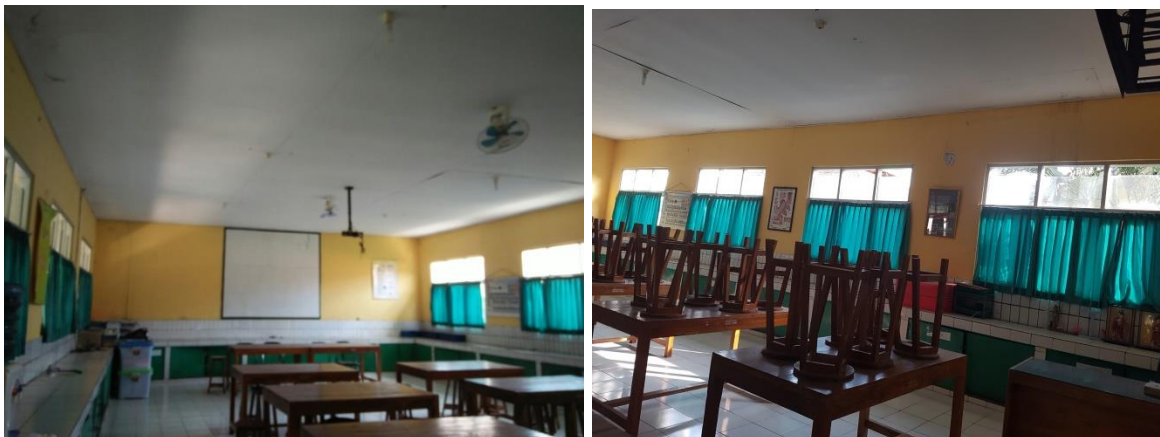
Gambar 6. Kondisi ruang laboratorium IPA sebelum retrofit
